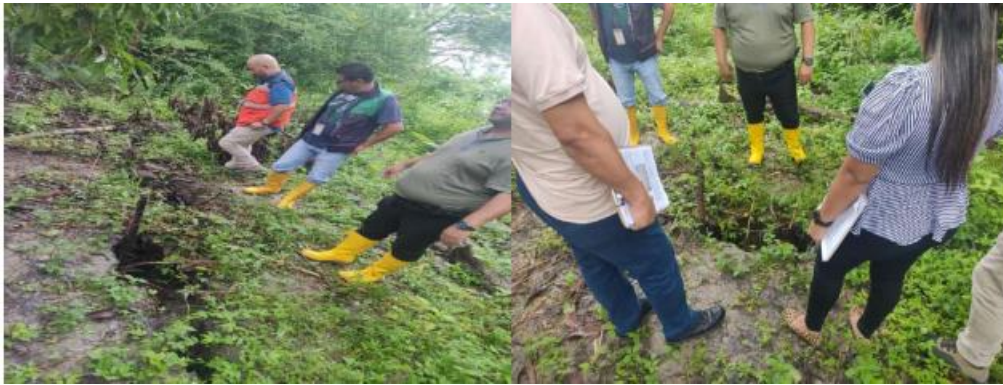
Fotos 1 y 2. Grieta y escarpa en hombro del deslizamiento superior
