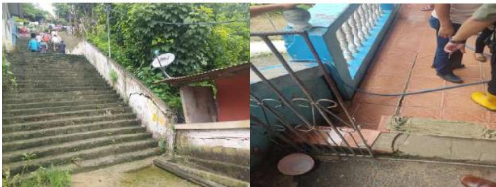
Fotos 3 y 4. Escalinata y labio del deslizamiento inferior.
