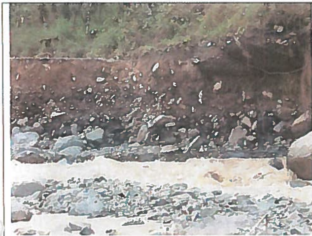
Foto 5. Destrucción de la vialidad por la acción de la erosión hídrica del río en la ribera izquierda del río.
