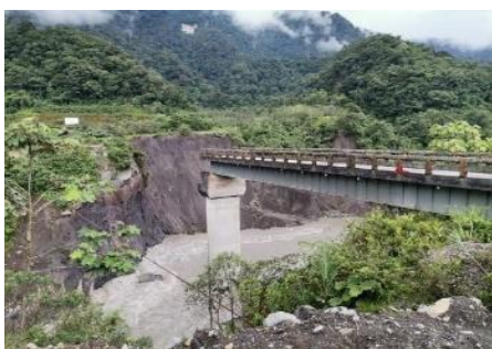
Colapso del puente Ventana 2, 19/05/2021
