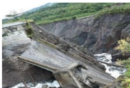
Colapso total del puente sobre el río Montana, 22/10/2020
