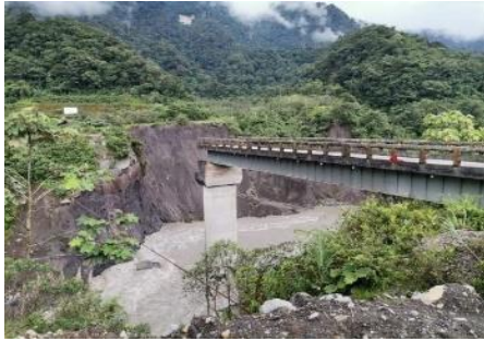
Colapso del puente Ventana 2, 19/05/2021
